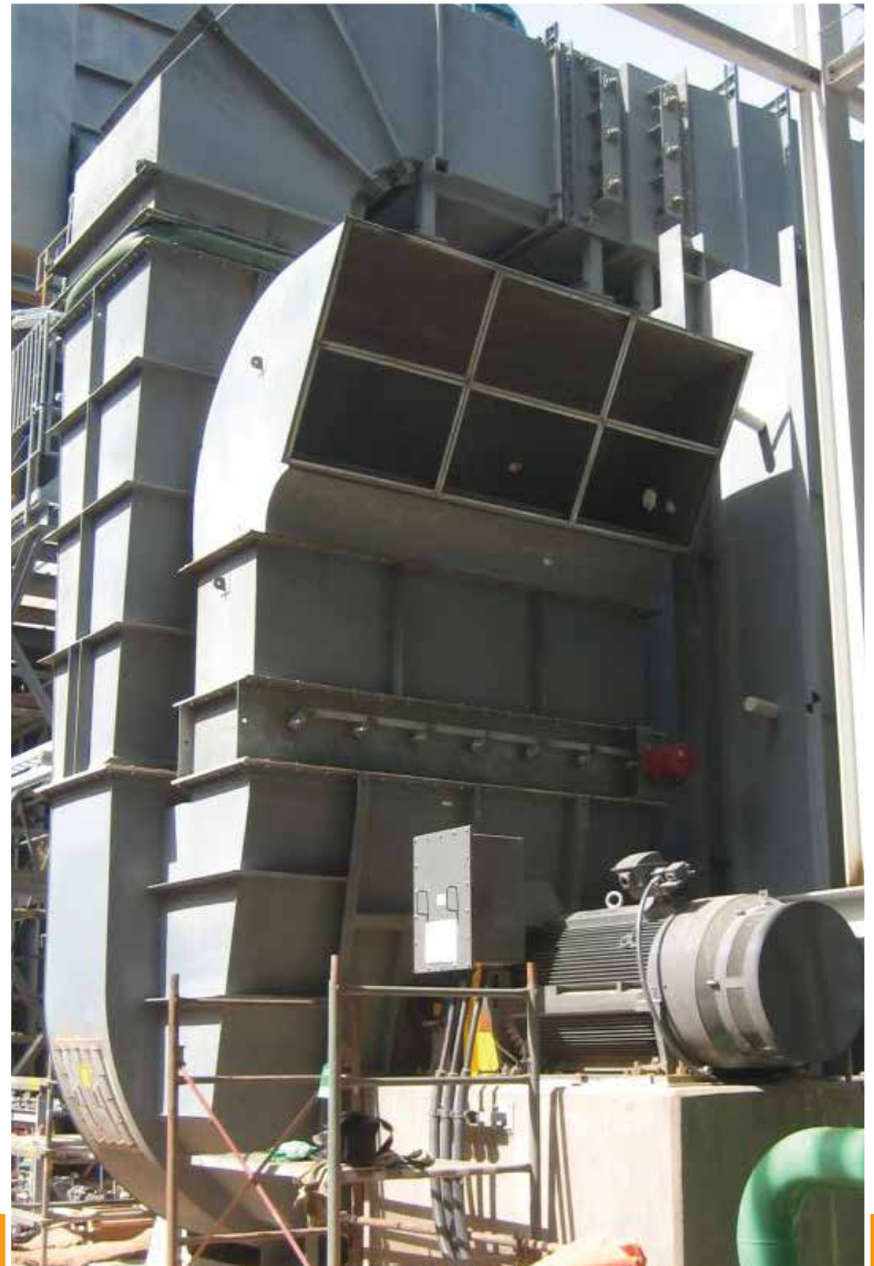
HRSG Dilution Air Fan- Bolivia
